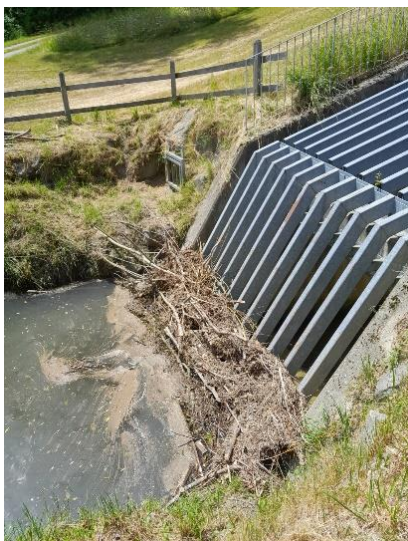
Rechen beim Rückhaltedamm nach Starkregen im Juni 2025
